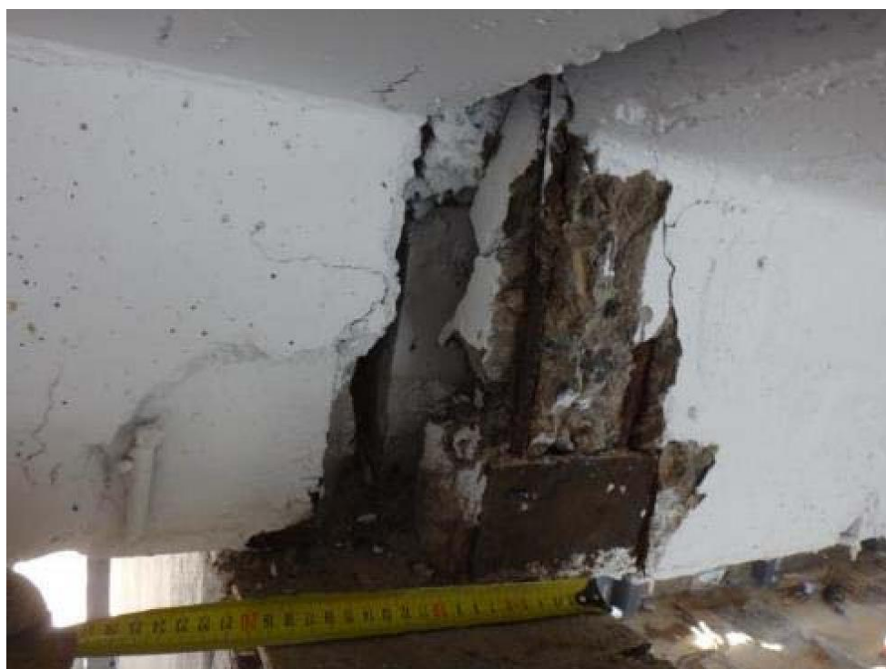
Рис.3. Разрушение опорной части ребристых плит покрытия
