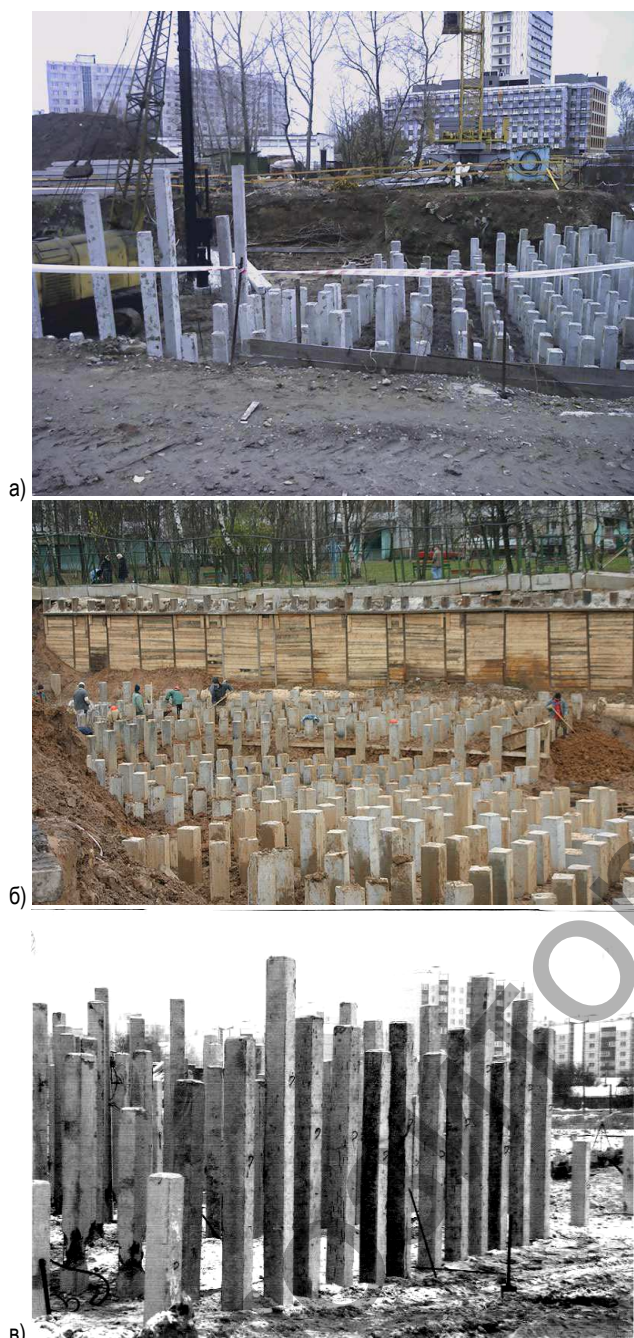
Рис. 1. Общие виды свайных полей: а) с различной недобивкой соседних свай; б) с малой недобивкой; в) со значительной недобивкой по всему полю
