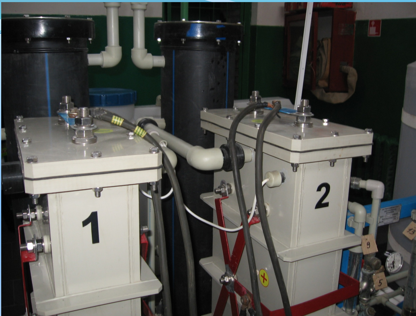
Электролизная установка Граевского водозабора г. Бреста
