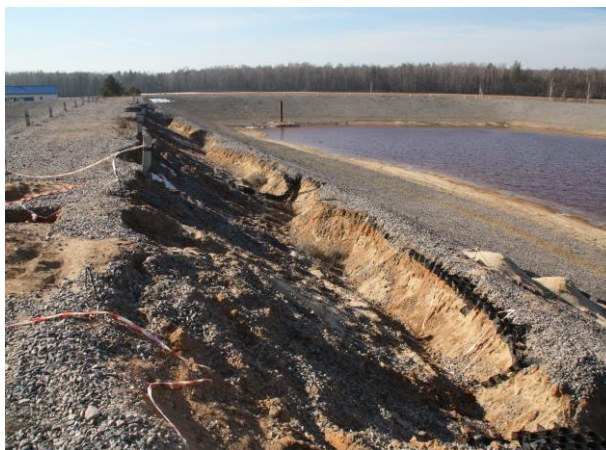
б) Разрушение верхового откоса дамб
