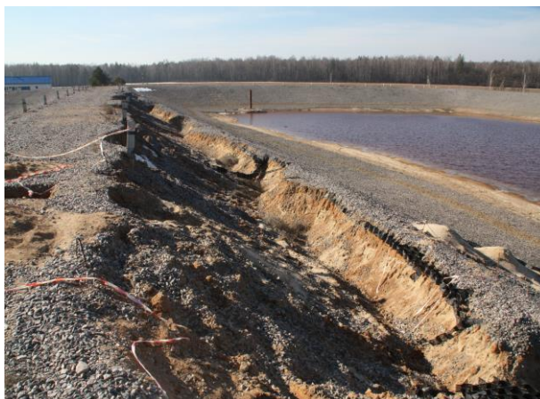
б) Разрушение верхового откоса дамб
