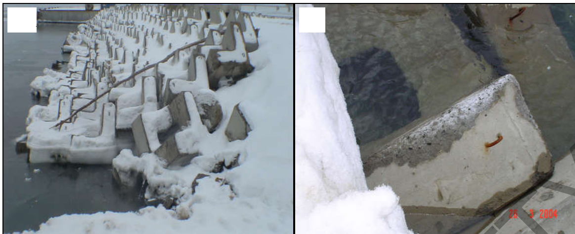
Рисунок 1 – А - общий вид берегозащитного сооружения корневой части причала МОФ (п. Пригородное, завод СПГ, о. Сахалин) в зимний период; Б - характер разрушения бетонных блоков (гексабитов) после первого зимнего сезона
