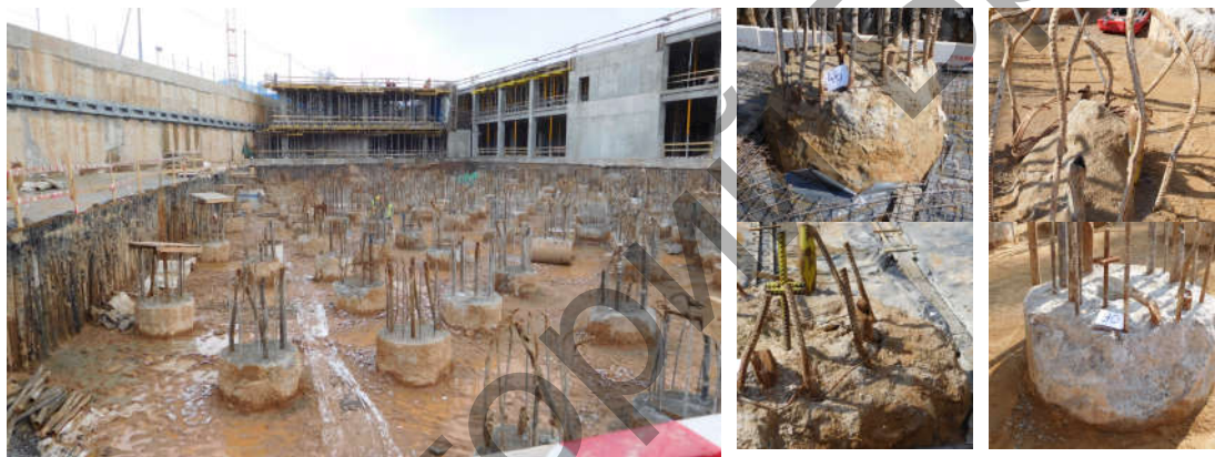
Рисунок 11 – Вид на свайное поле при отрывке котлована до низа бетонной подготовки под фундаментную плиту и дефекты отдельных голов свай
