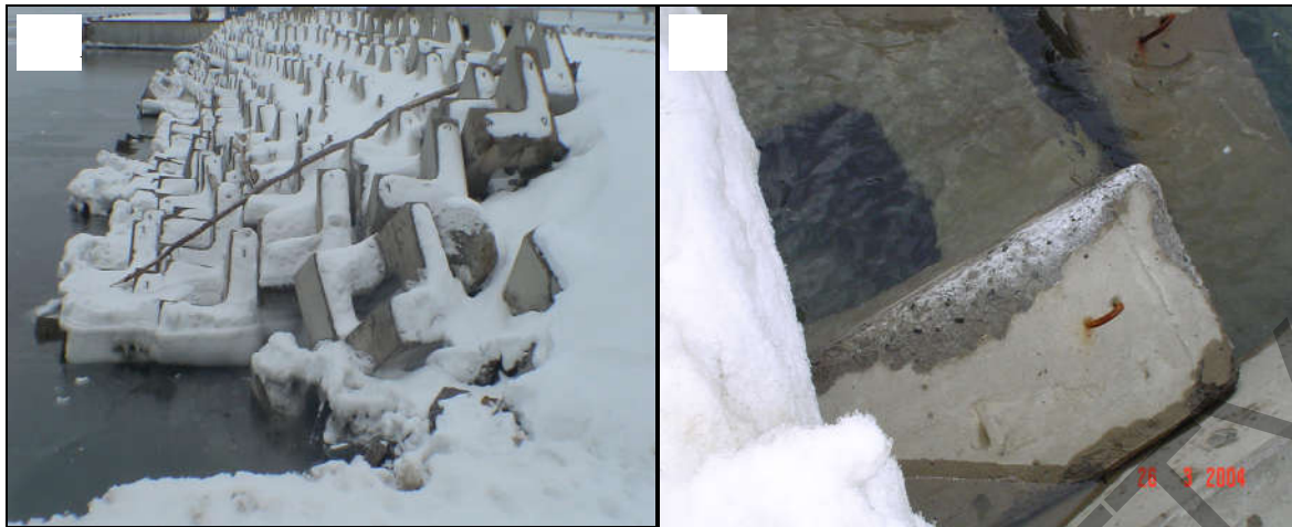
Рисунок 1 – А - общий вид берегозащитного сооружения корневой части причала МОФ (п. Пригородное, завод СПГ, о. Сахалин) в зимний период; Б - характер разрушения бетонных блоков (гексабитов) после первого зимнего сезона
