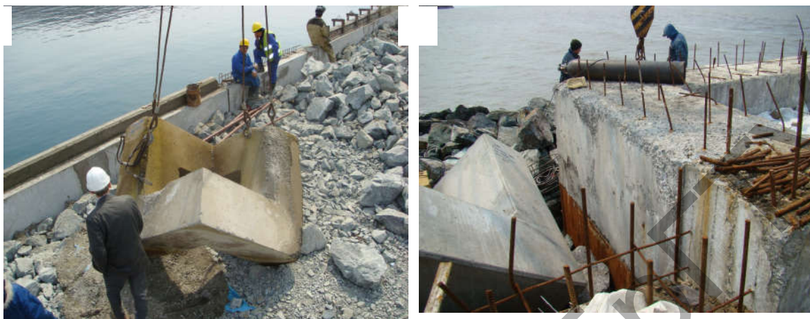
Рисунок 2 – Характерный вид разрушения бетона в зоне переменного уровня после первого зимнего сезона: А- берегоукрепление из гексабитов в порту Козьмино (г.Находка, Приморский край, 2008 г); Б- причальная стенка в порту Углегорск (о. Сахалин, 2010 г).
