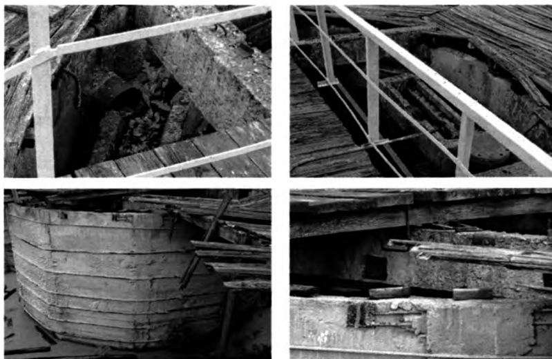
Рис. 4.8. Техническое состояние осветлителей-перегнивателей
