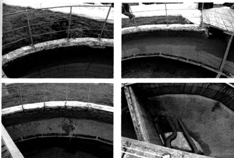
Рис. 4.4. Техническое состояние песколовков
