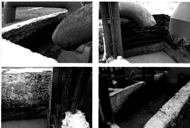
Рис. 4.2. Техническое состояние приемной камеры
