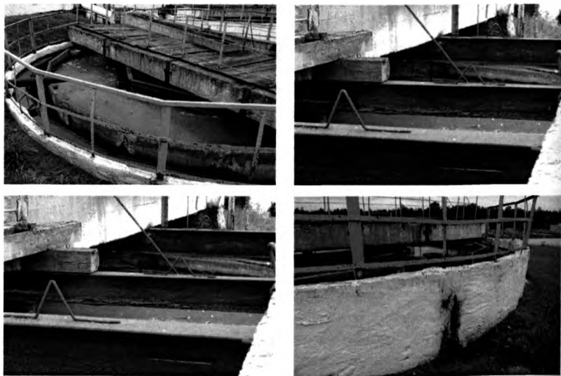
Рис. 4.6. Техническое состояние первичных отстойников
