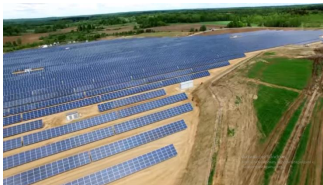
Рис. 2. – Солнечная электростанция ЗАО «Модус Проджектс», Мядель
