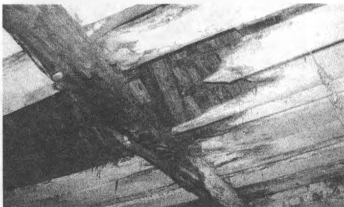
Рисунок 21 - Разрушение гнилью настила перекрытия
