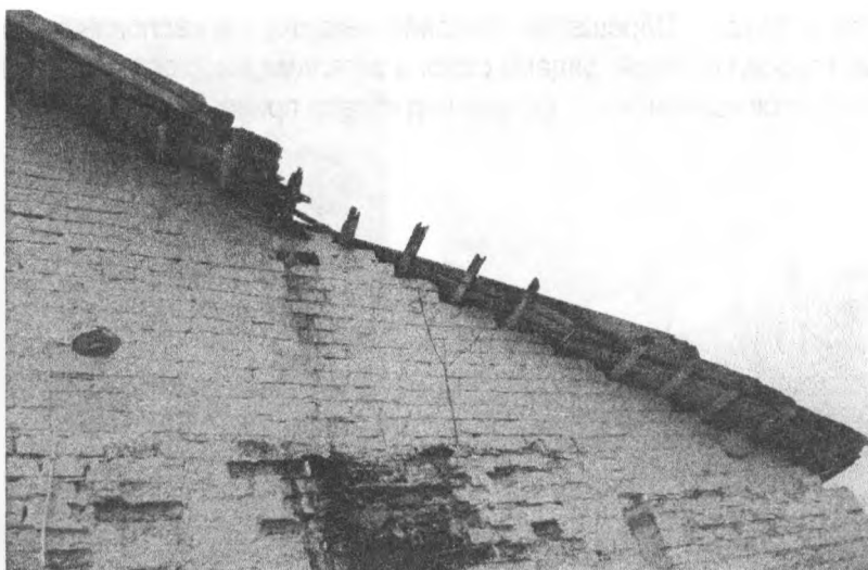
Рисунок 25 - Разрушение кровли над фронтоном восточного фасада
