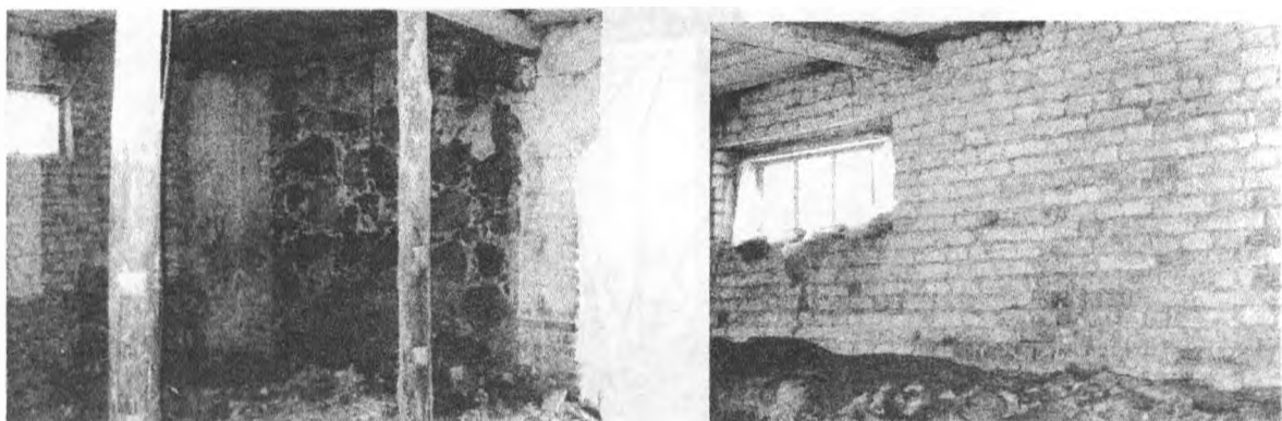
Рисунок 14 - Кладка стен из бута и кирпича глиняного (фото слева). Вид с внутренней стороны западной торцевой стены. Однорядная цепная система перевязки кладки из силикатного кирпича (фото справа). Южная продольная стена. Время возведения вторая половина 50-х годов XX века
