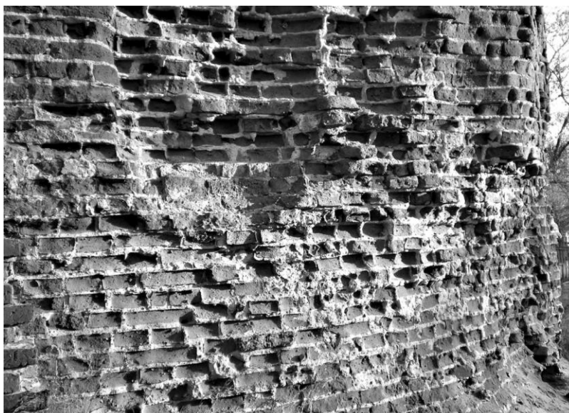
Рисунок 2 – Коррозионное разрушение кирпичной кладки вследствие сильного увлажнения и засоленности.
