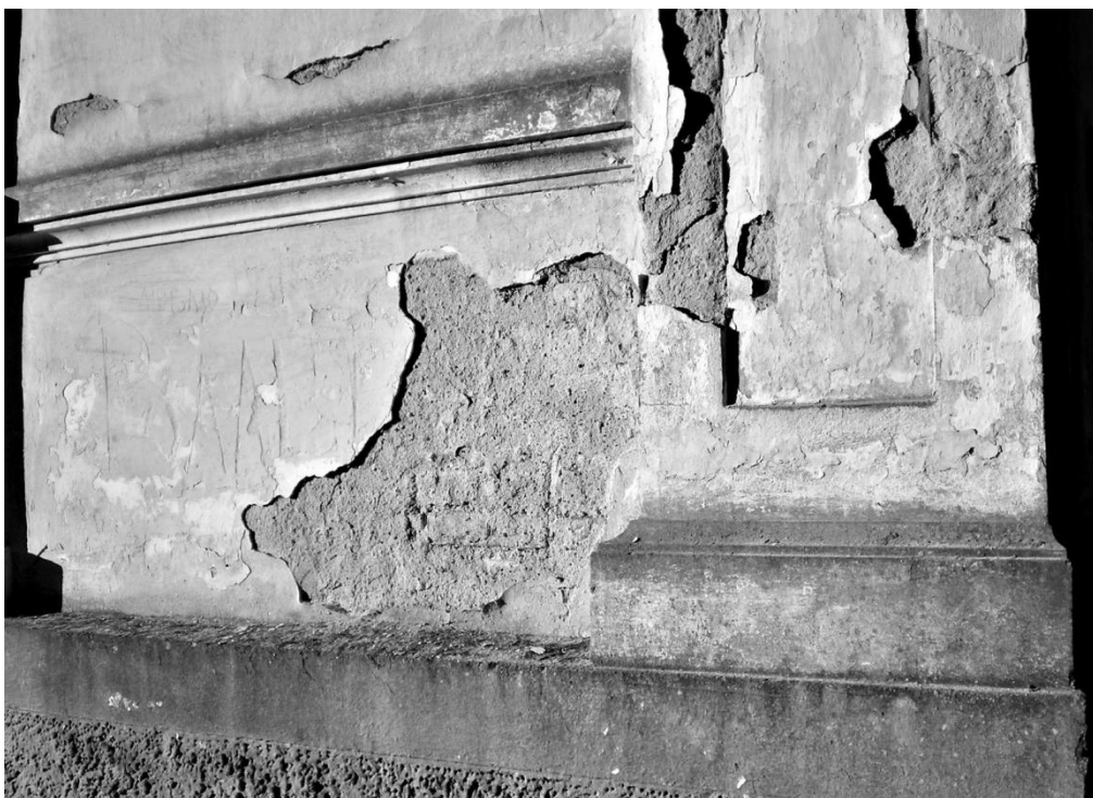
Рисунок 1 – Штукатурка, отколовшаяся от цоколя здания вследствие кристаллизации солей (пример коррозионного действия капиллярно поднимающейся влаги в сочетании с сильными высолами)
