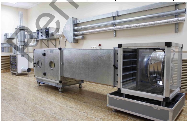
Рисунок 1 – Часть стендов лаборатории “Вентиляция”
