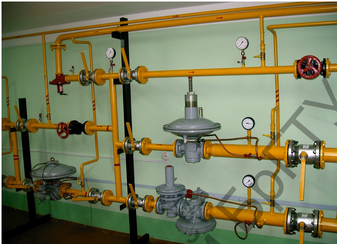
Рисунок 5 – Стенд “Газорегуляторная установка” лаборатории “Газоснабжение”
