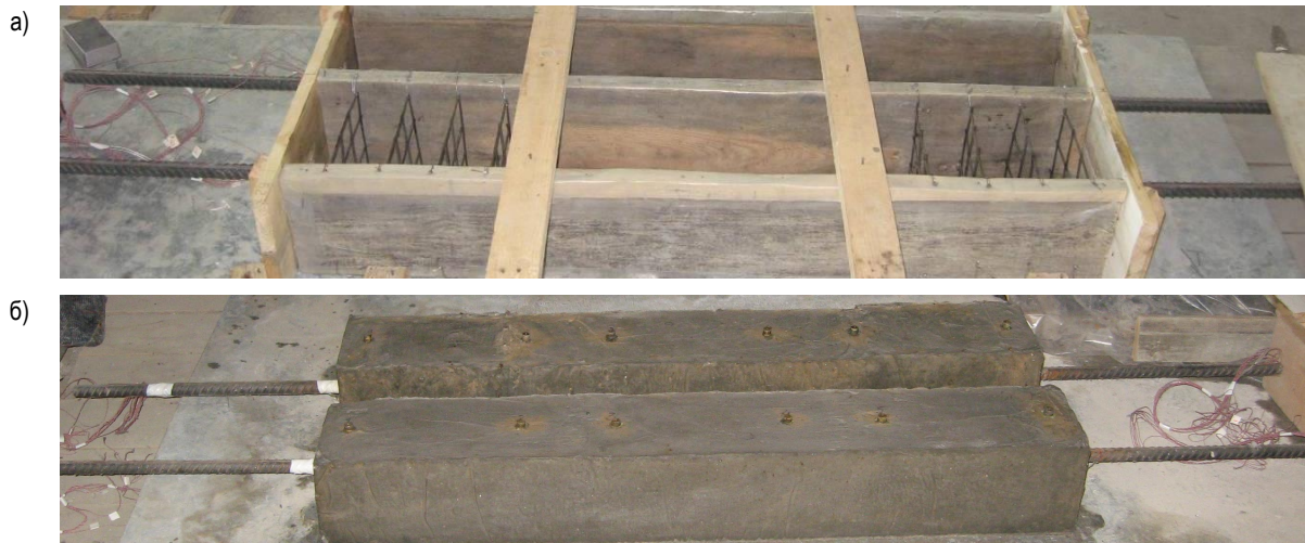
Рис. 4. Опытные образцы Б-4-С и БС-4-С до бетонирования (а) и после распалубки (б)
